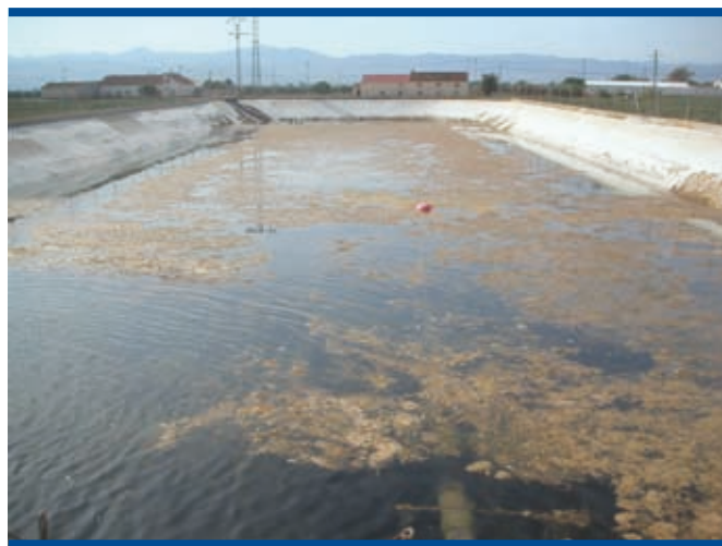
Foto 6. Balsa de aspiración de un bombeo con algas y ovas en suspensión
