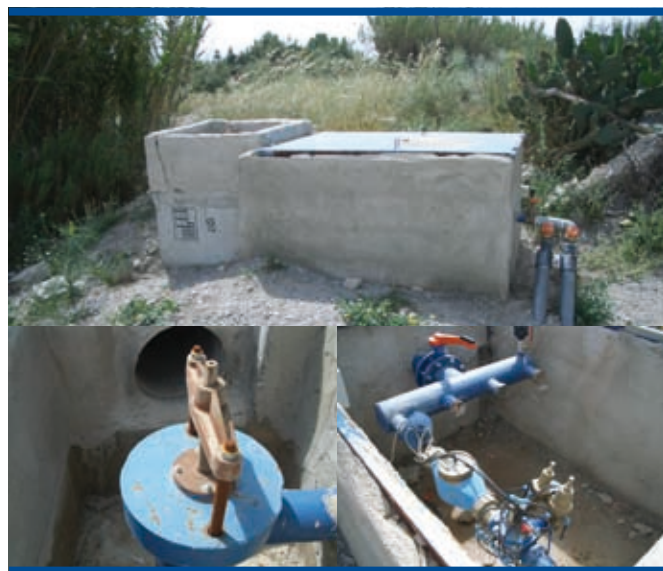
Foto 9. Hidrante colectivo para riego a presión y por gravedad en la misma arqueta
