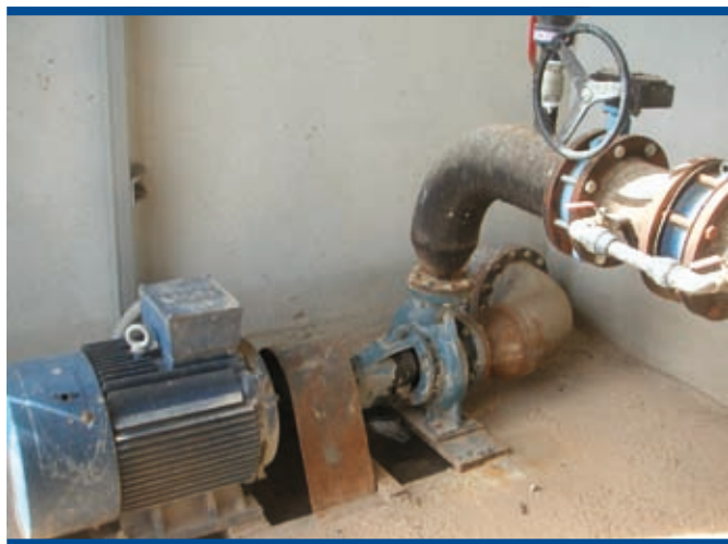
Foto 7. "Bypass" en la válvula de retención de una impulsión
