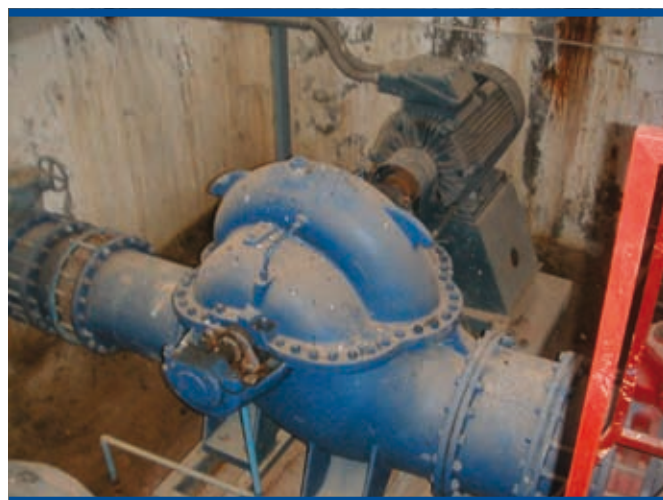
Foto 13. Bombeo con un mantenimiento deficiente
