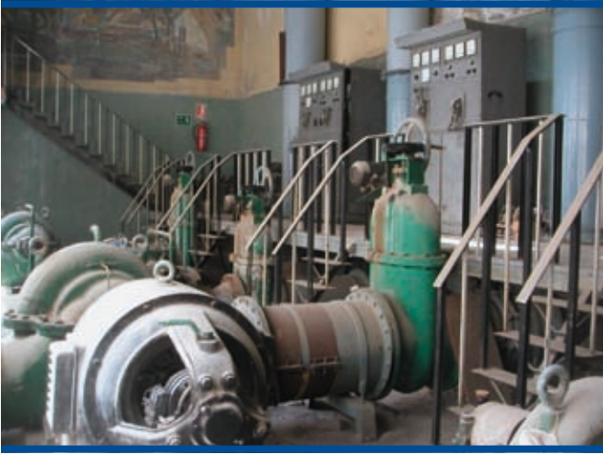
Foto 3. Equipos de bombeo antiguos en desuso en la comunidad de regantes de Lorca
