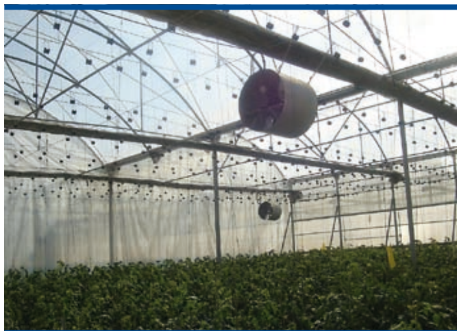
Foto 18. Ventilador para movimiento horizontal del aire dentro de un invernadero
