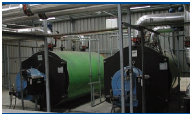
Foto 20. Instalación de calefacción en un invernadero con dos calderas para generación de agua caliente
