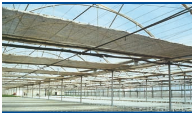
Foto 9. Invernadero con pantallas térmicas aluminizadas
