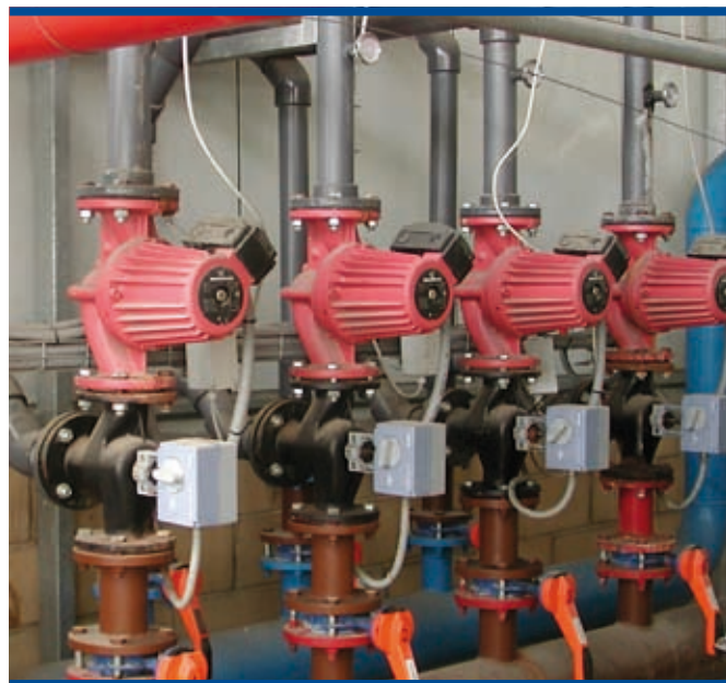
Foto 19. Bombas de impulsión de caudal variable para la distribución del agua de calefacción en invernaderos
