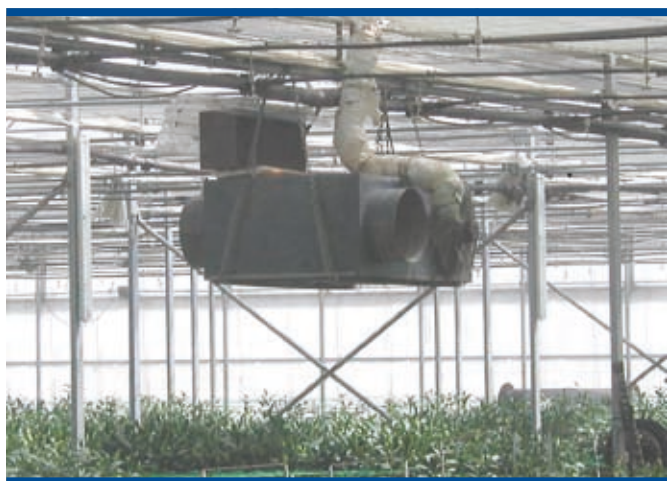
Foto 2. Generadores de calor por combustión indirecta
