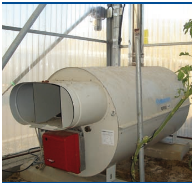
Foto 22. Intercambiadores de calor en un generador de aire caliente de combustión indirecta en un invernadero
