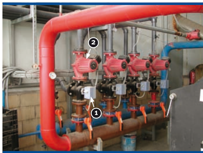
Foto 4. Instalación de calefacción por agua con válvulas de tres vías (1) y bombas de caudal regulable (2)
