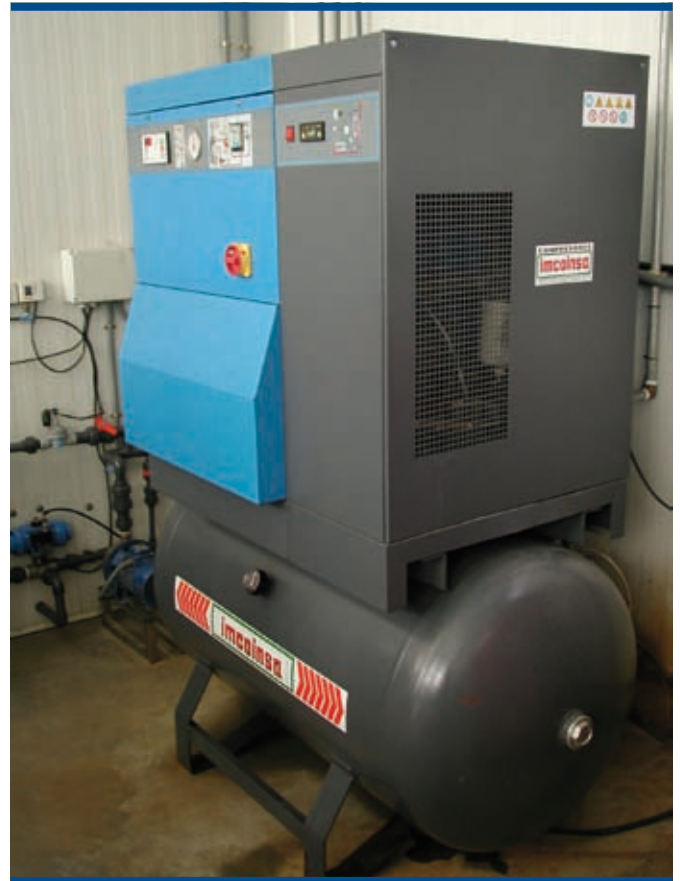
Foto 26. Compresor de aire y bomba de impulsión del agua en una instalación de nebulización
