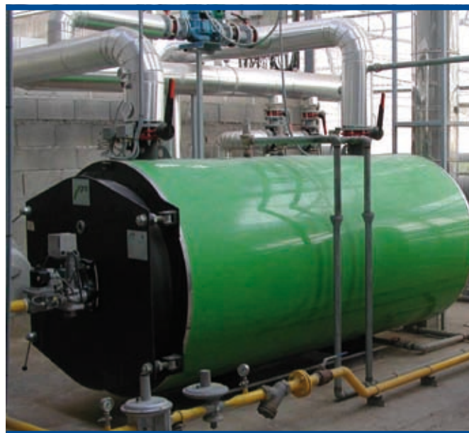
Foto 15. Aislamiento de la caldera y de las tuberías de calefacción mediante coquillas
