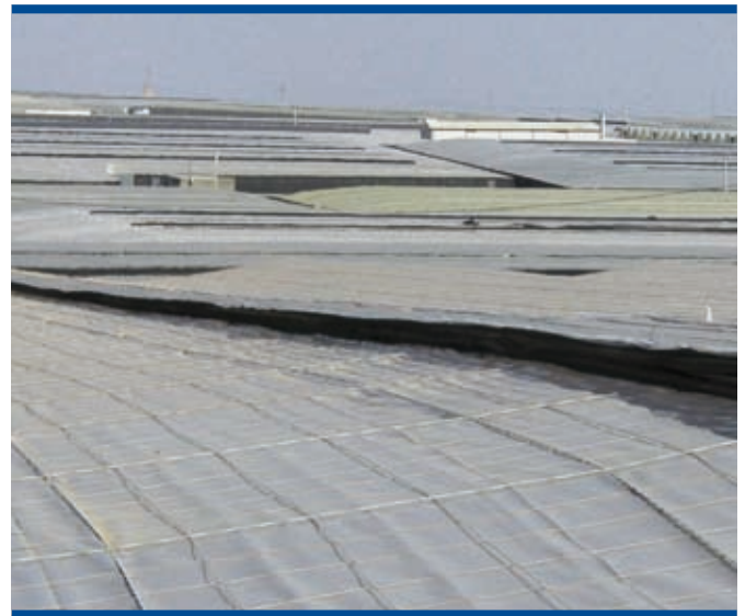
Foto 24. Aberturas cenitales de ventilación en un invernadero de tipo Almería cubiertas por malla anti-insectos
