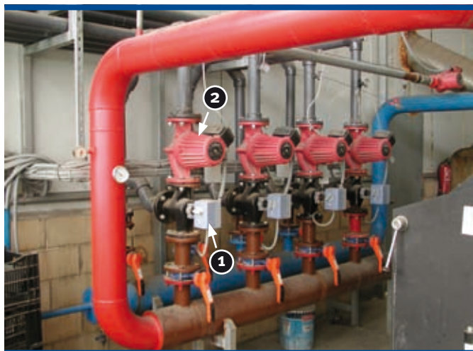
Foto 3. Instalación de calefacción por agua con válvulas de tres vías (1) y bombas de caudal regulable (2)
