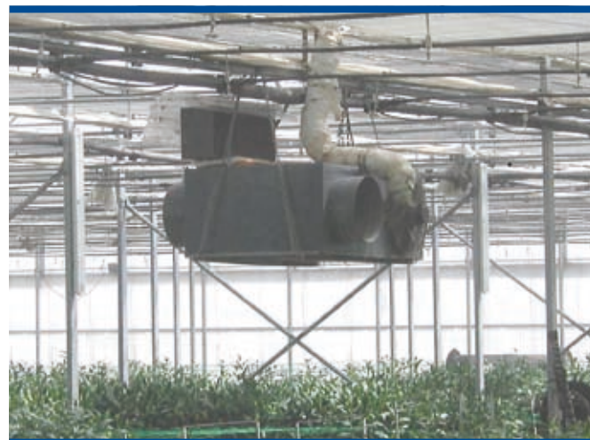
Foto 4. Generadores de calor por combustión indirecta
