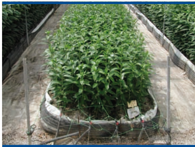
Foto 7. Instalación de tuberías de calefacción alrededor del sustrato en el invernadero analizado en Mendigorriá
